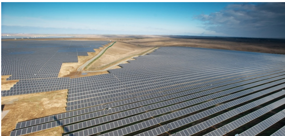
Рис. 2. «Перово» – солнечная электростанция общей мощностью 105,56 МВт, расположенная возле села Ключи Перовского сельского совета в Крыму. Электростанция состоит из 440 000 кристаллических солнечных фотоэлектрических модулей, соединенных 1 500 км кабеля и установленных на площади более 200 га. Электростанция может производить 132,5 млн кВт·ч возобновляемой электроэнергии в год (фото Wikipedia)
